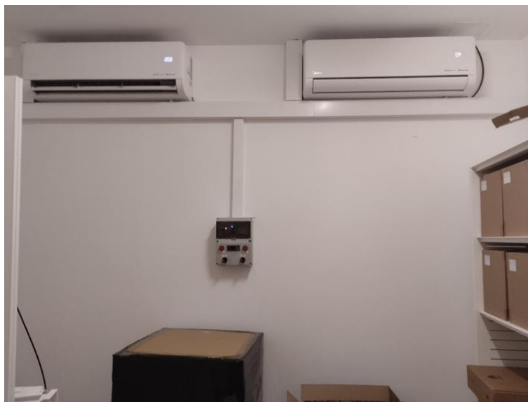
Figura 8 - Sala de servidores e armazém de mercadorias
